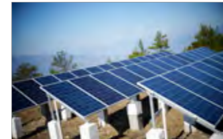
光伏扶贫项目
